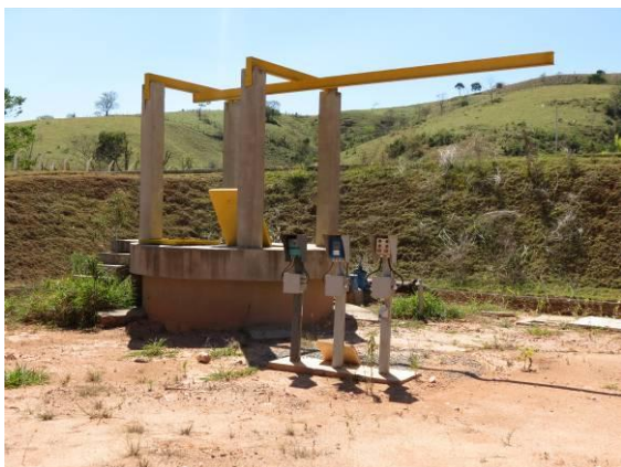
Figura 15: Estação elevatória da ETE.
